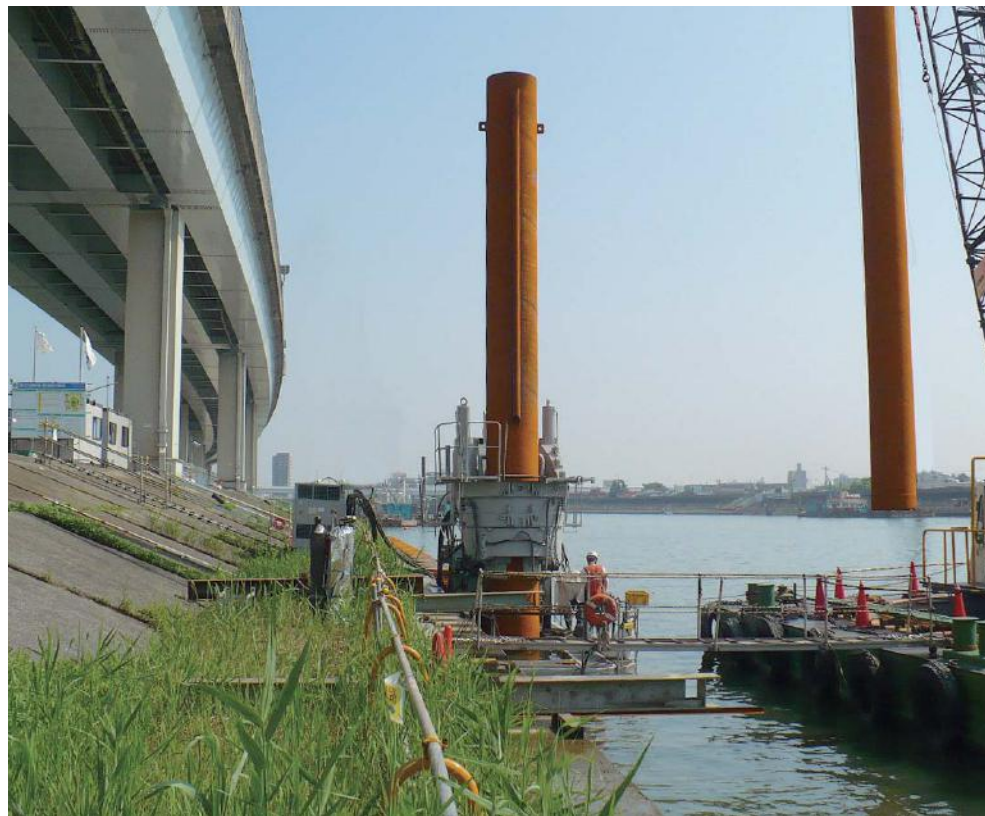
鋼管矢板圧入工法による高速道路に近接した都市河川護岸工事
